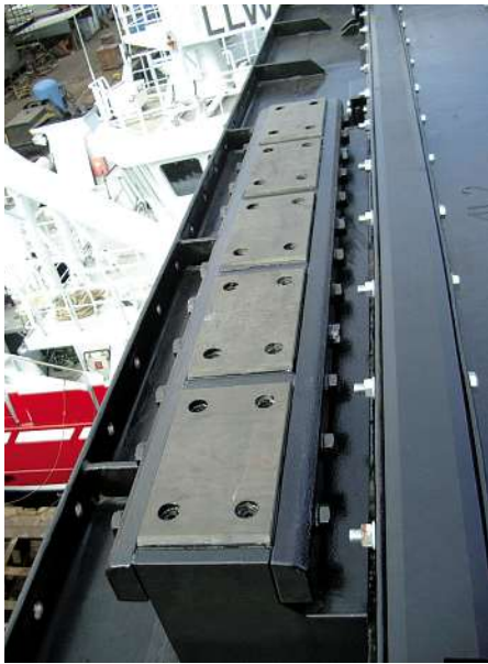
Acht Kenterkufen sorgen für das wartungsfreie Gleiten der 2400 t schweren Tore der Kaiserschleuse.
